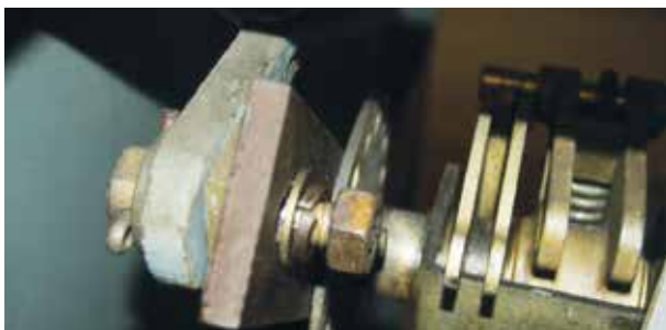
Bild 4: Lose Mutter an Schaltgestänge eines Sicherungslasttrennschalter [5]
