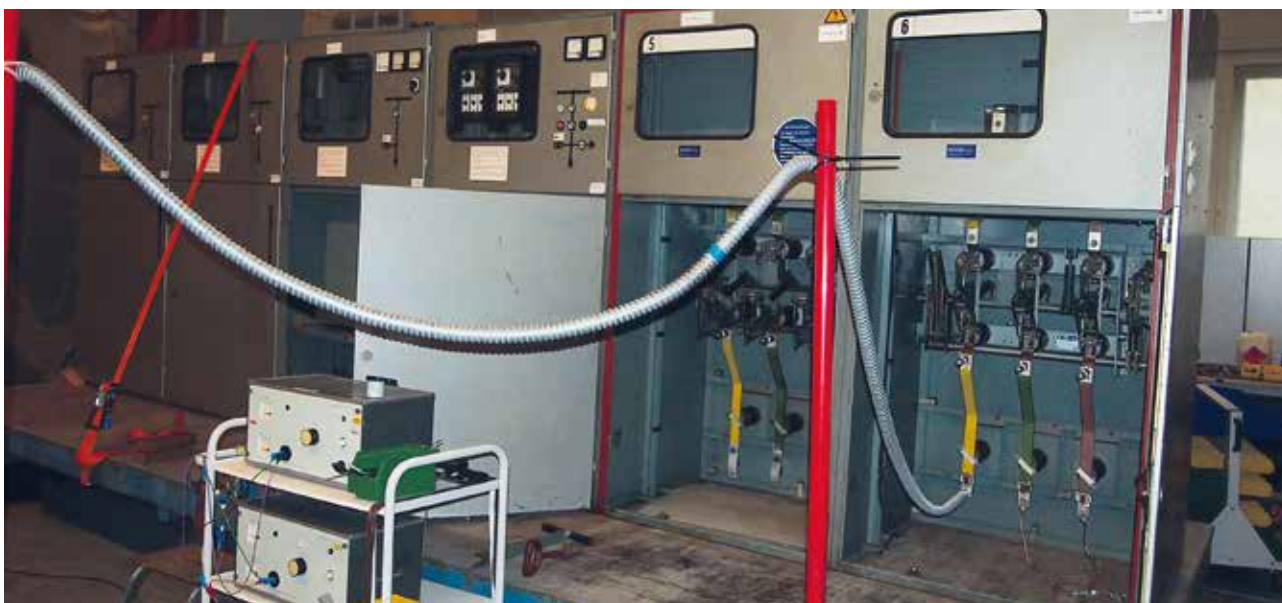
Bild 1: CSI Schaltanlage im Hochspannungsprüffeld der IPH GmbH [5]
